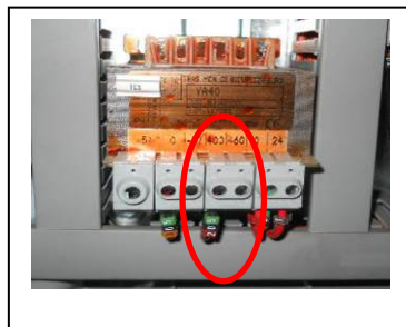
Figura 5 Trasformatore impostato a 400 V
