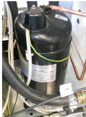
Abbildung 21 – Position des Kompressors
