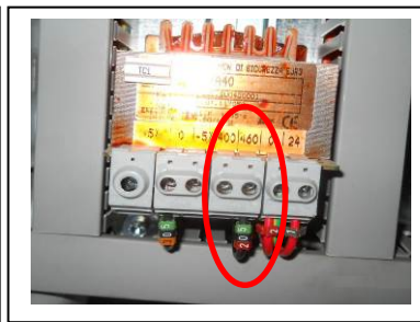
Figura 6 Trasformatore impostato a 460 V
