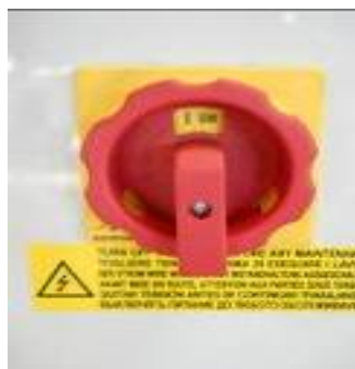
Abbildung 16 – Hauptschalter auf ON
