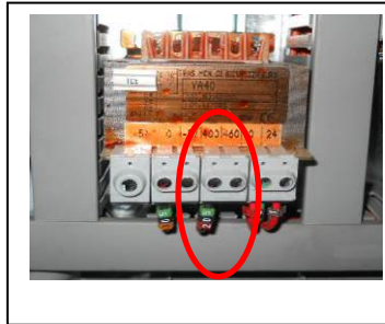
Abbildung 5 Auf 400V eingestellter Transformator
