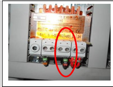
Abbildung 6 Auf 460V eingestellter Transformator
