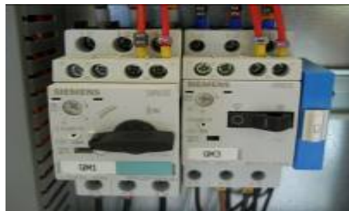
Figura 8 – Interruttori di circuito OFF
