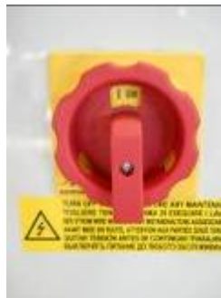
Figura 16 – Interruttore generale su ON
