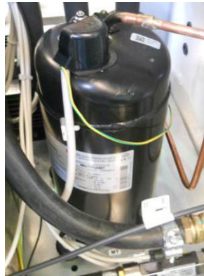
Figura 21 – Posizione del compressore
