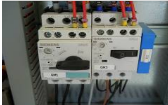
Abbildung 15 – Pumpenschalter auf ON
