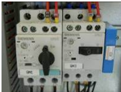
Abbildung 19 – Alle Trennschalter auf ON
